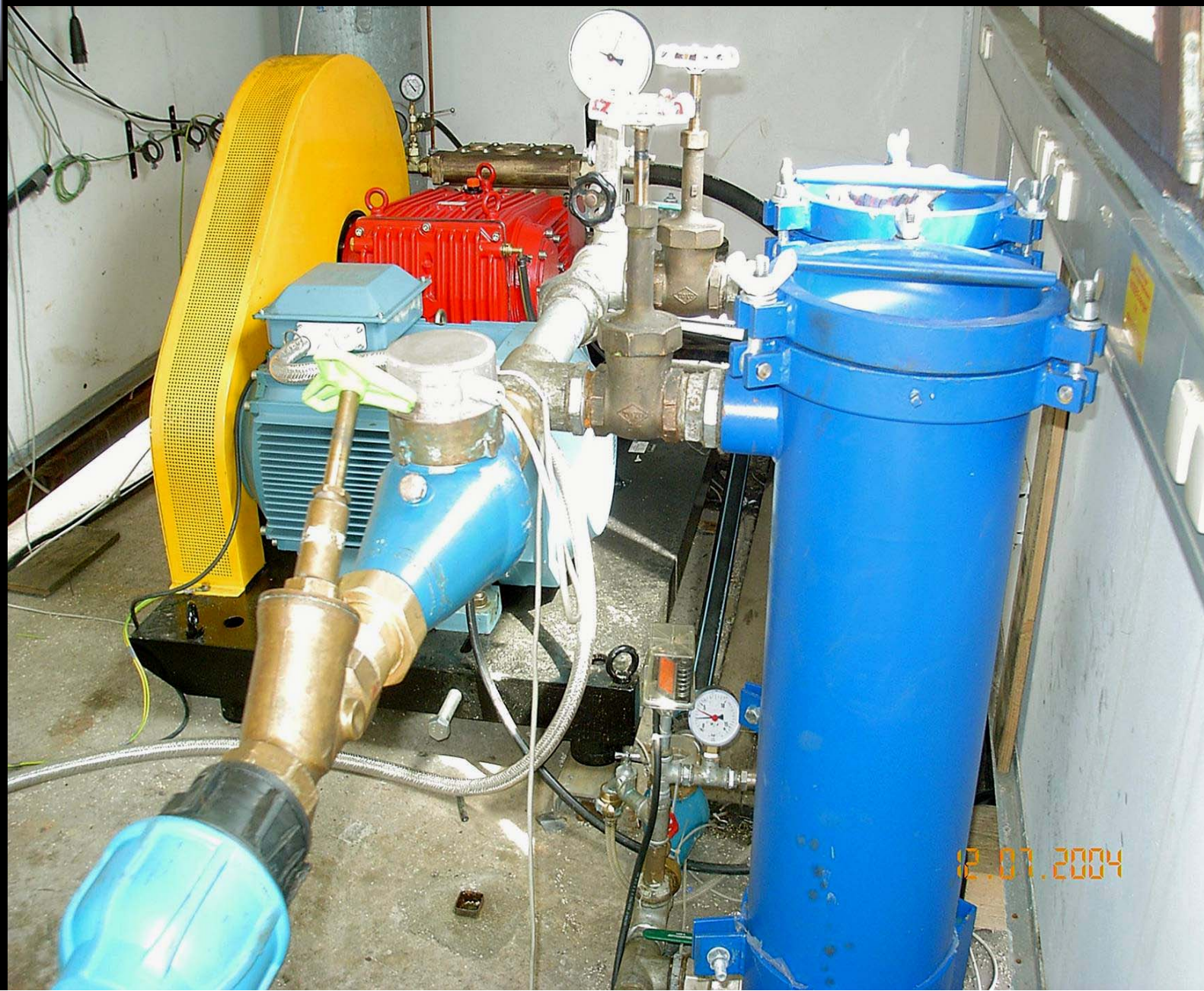
Pumpen- system KTB-VB Injektion
